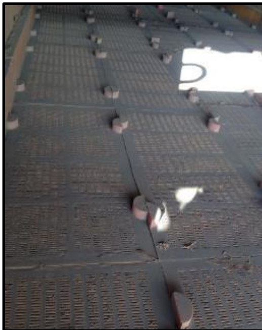
FIGURA 2 – Telas no deck da peneira de proteção.
